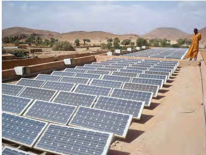
Sonpanele op 'n dak.
