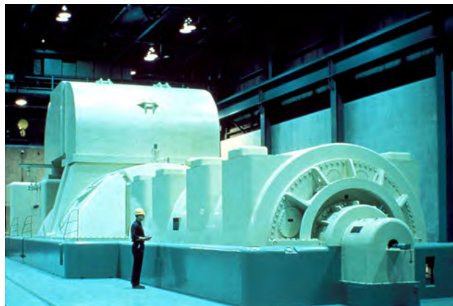
'n Moderne stoomturbine wat aan 'n generator gekoppel is.
